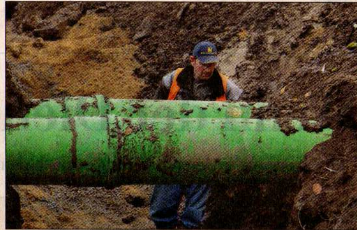
Ein riesiges Loch klappte nahe Gut Uhlenhorst, wo die Schmutzwasserleitung die Mühlenau unterquert. Foto Müller/Archiv
