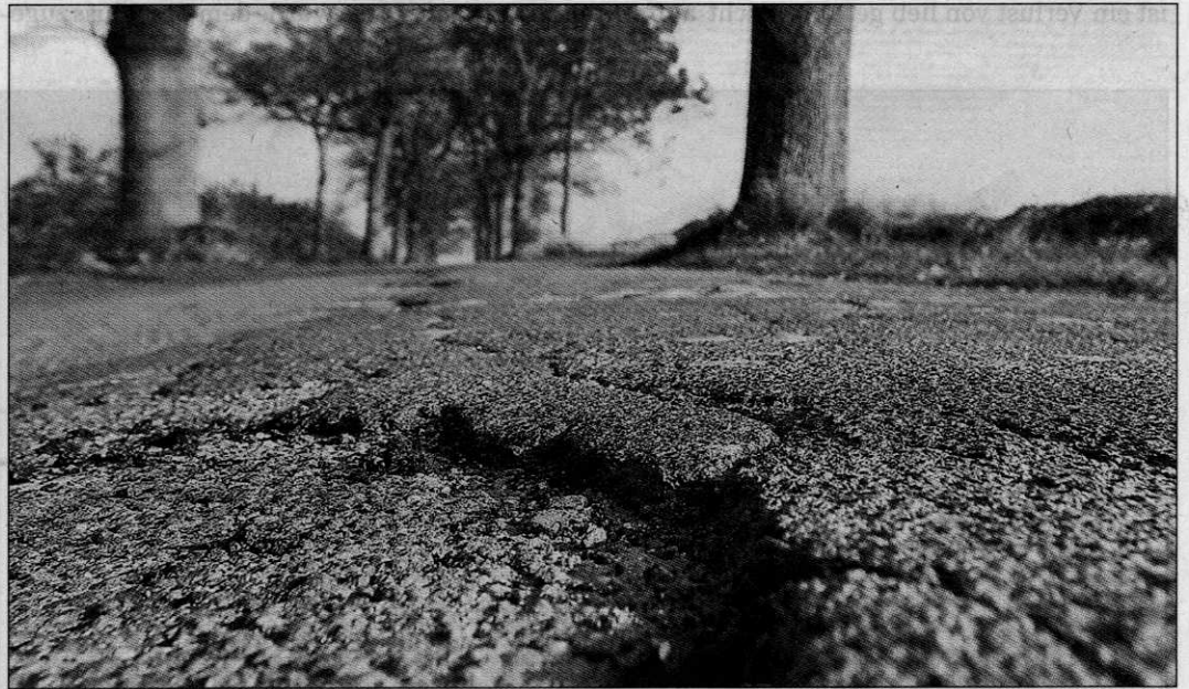
Übersät mit Schlaglöchern und Flickstellen: der Sturenhagener Weg.
